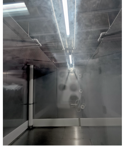
Tiefkühlagerraum: Die Temperatur von -80 °C wird durch Kühlung mit flüssigem Stickstoff gehalten
