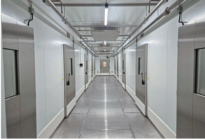
Blick in den Lagerkomplex: Die Türen führen zu den einzelnen unterschiedlich temperierten Lagerräumen
